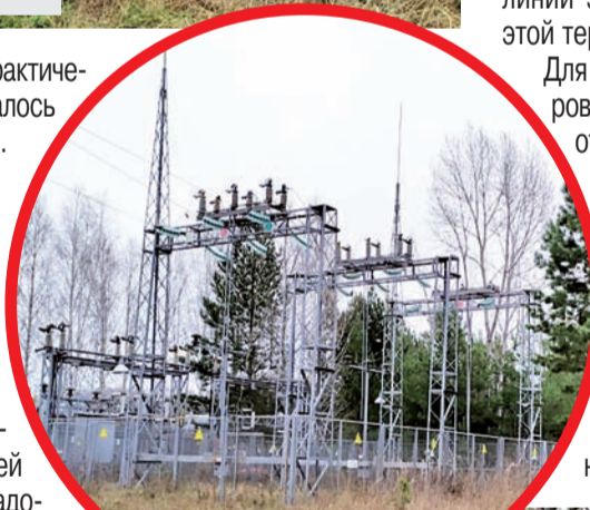
Подстанция, от которой планируют тянуть электричество в 42-е сады, расположена в СНТ №34.
